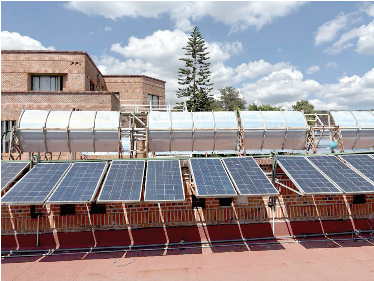
FIGURA 2. SISTEMA de paneles fotovoltaicos (al frente) y concentradores de calor (atrás) colocados en el CIICap UAEM.
