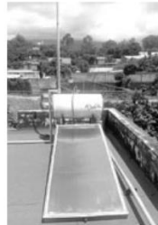
3. Calentador solar de agua en la azotea de una casa habitación.
