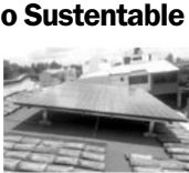
2. Celdas fotovoltaicas instaladas en la azotea de una casa habitación.
