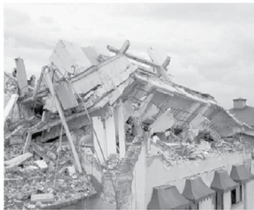
a) Daños en un edificio en Cuernavaca
