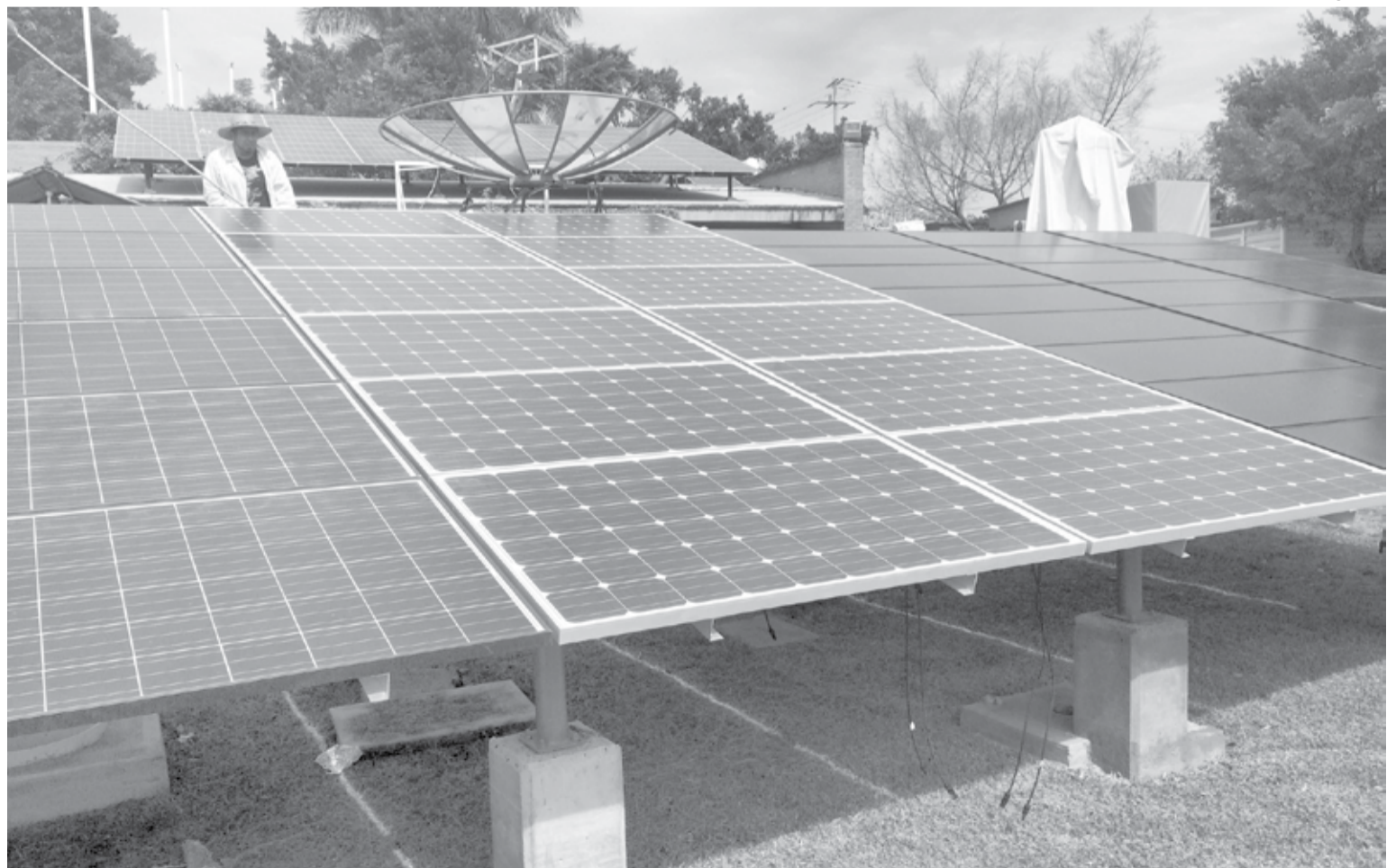
Figura 4. Panel fotovoltaico para obtener electricidad del Sol.
