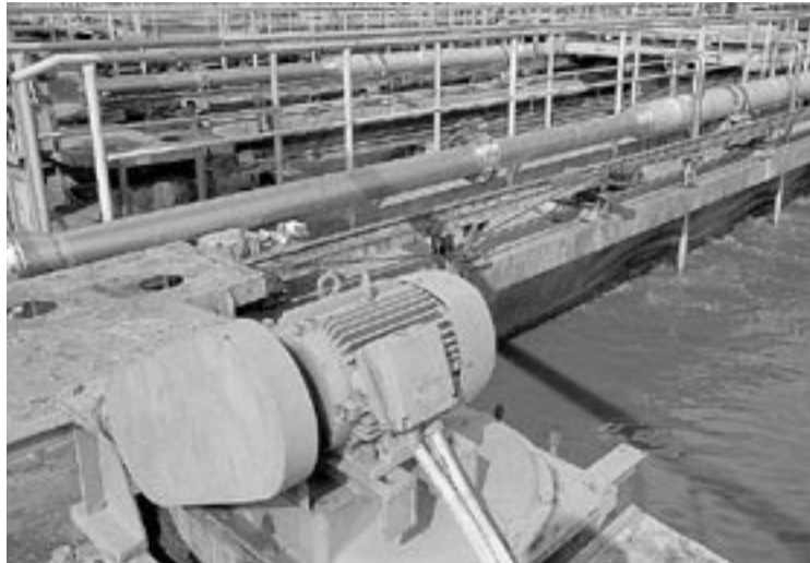
Planta de tratamiento de aguas residuales. Fotógrafo: Petr Jan Juracka
