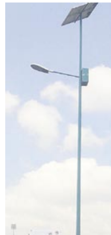
2. Postes en el libramiento de la autopista con receptáculo para luminarias y con un panel de celdas solares en el extremo superior.
